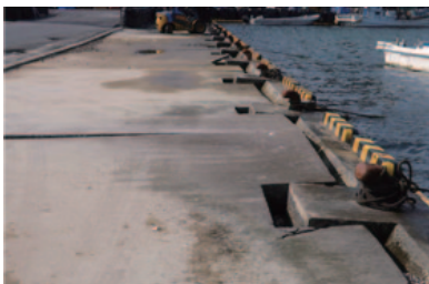
竹浜 いまにも崩れそうな岸壁
