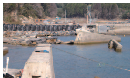
小網倉浜 無残に破壊されたままの港
