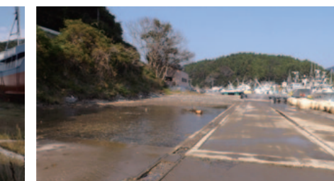
小淵浜 地盤沈下で海水が引かない
