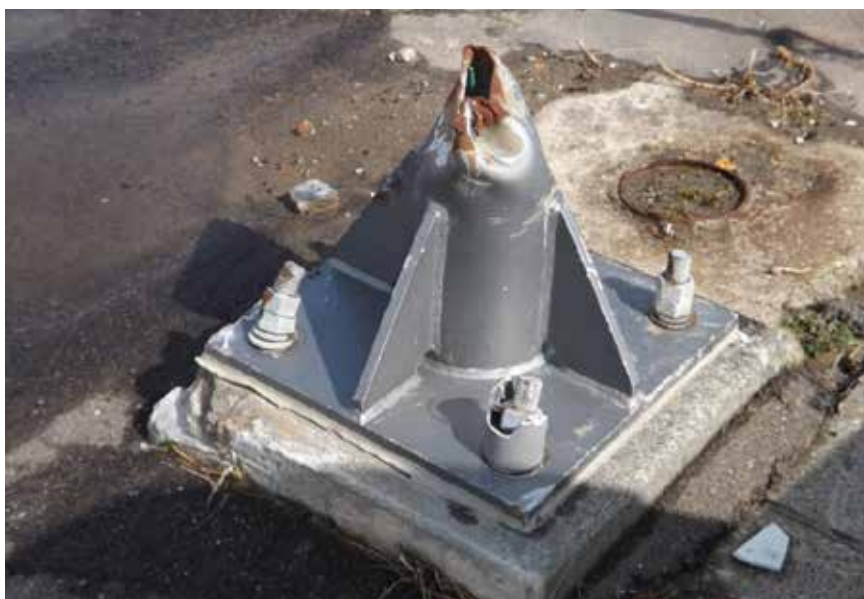
津波に破壊された街灯の鉄製支柱
