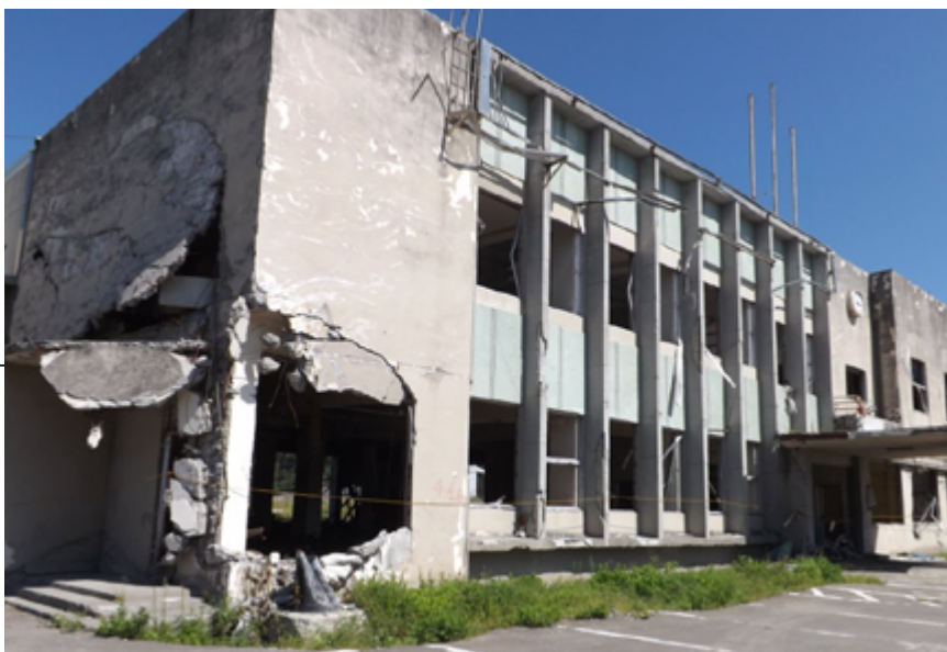
破壊されたままの大槌町役場
