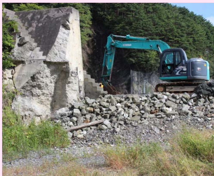
鵜住居の破壊された堤防
