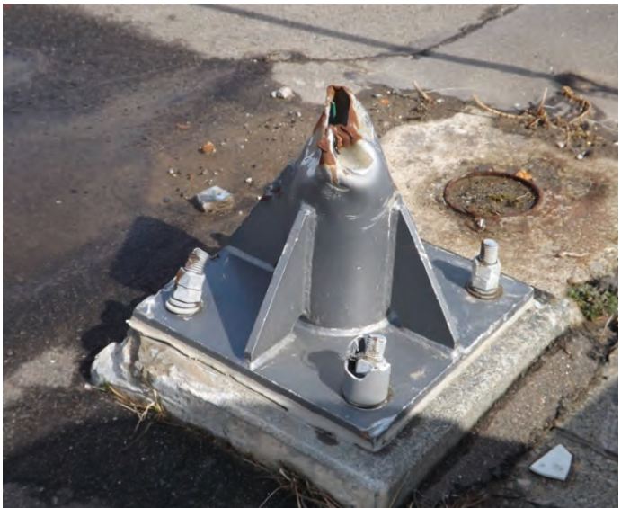
津波に破壊された街灯の鉄製支柱
